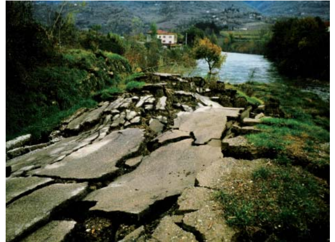
Fig. 4 - I danni alle vie di comunicazione, conseguenti al movimento franoso de "Le Mottacce" (foto: Walter Dragoni) - The damages to the Arezzo-Stia railroad, consequent to mass movement of "Le Mottacce" (photo by Walter Dragoni)
