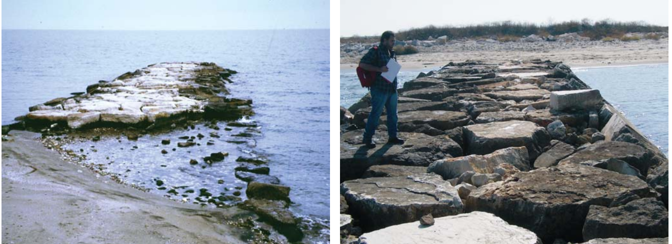
Fig. 15 a,b - Cattiva manutenzione delle opere - Bad maintenance of the works
