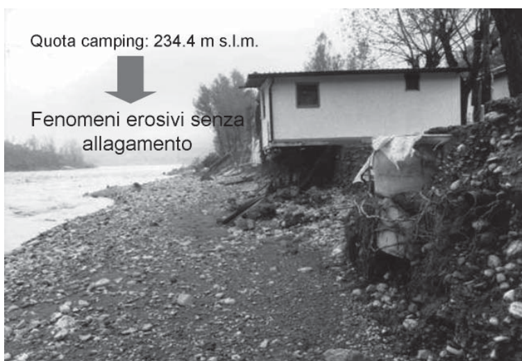
Fig. 17 - Erosione causata dall'alluvione del 2001 sulla sponda destra della gola di Barberino - Erosion produced by the 2001 flood on the right bank of the Barberino gorge
