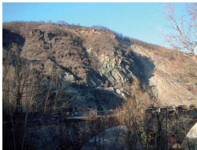
Fig. 15 - La frana di Barberino vista nel suo complesso - A view of the whole Barberin landslide
