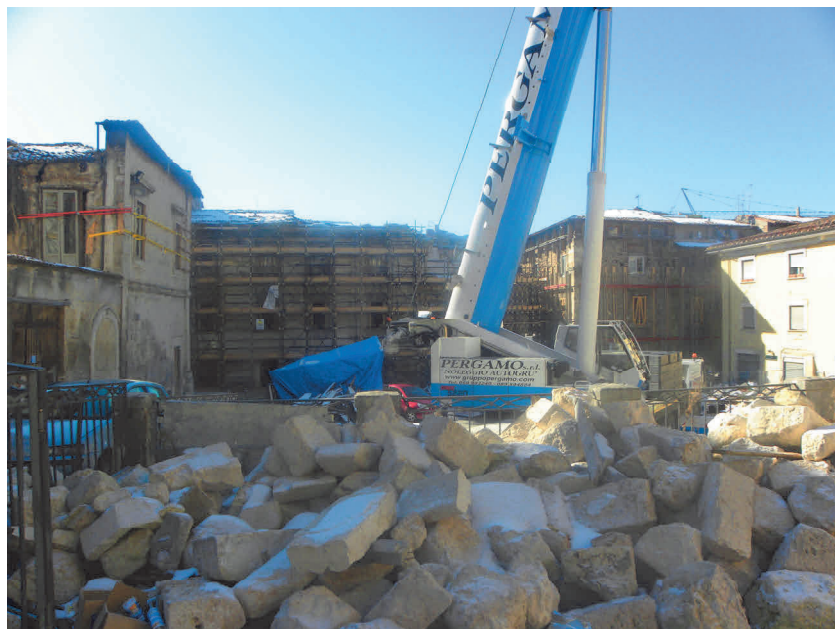
Figura 2. Piazza di San Pietro a Coppito (a L'Aquila) ripresa dal cortile di accesso all'omonima chiesa, di cui in primo piano si osservano i considerevoli effetti dei fenomeni di crollo registrati in un'altra area-cantiere.
