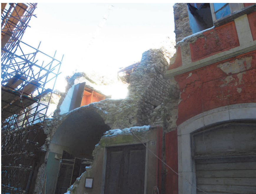
Figura 4. Ingenti danni riportati da un edificio in prossimità dell'Università degli Studi dell'Aquila. Foto: C. Pesaresi (febbraio 2010).
