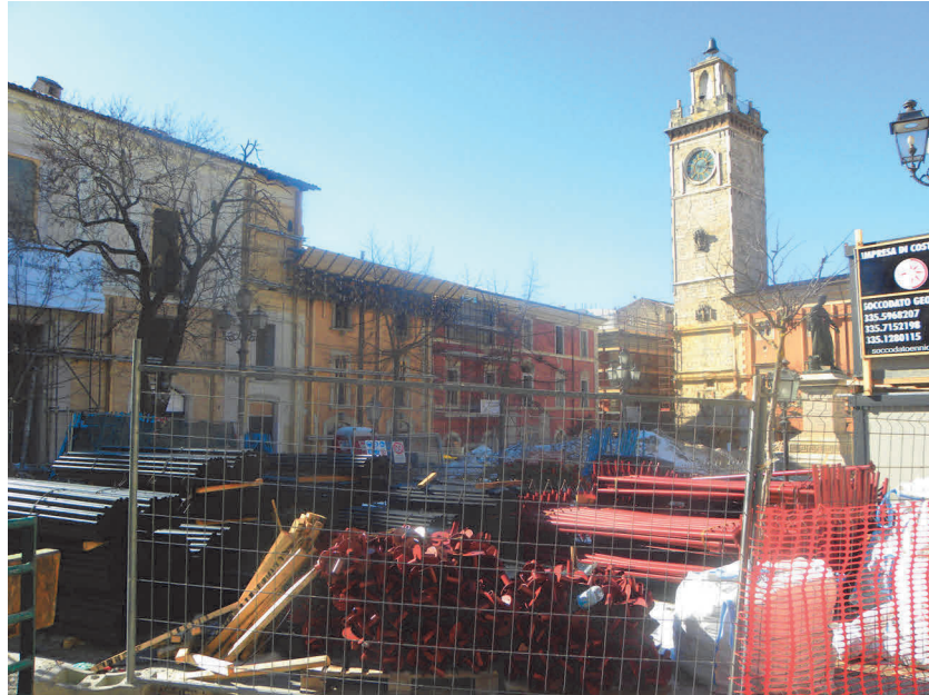
Figura 1. Piazza del Palazzo (a L'Aquila), con la torre Civica di palazzo Margherita (sede del Comune) sullo sfondo, si presenta come un'area-cantiere pressoché deserta.
