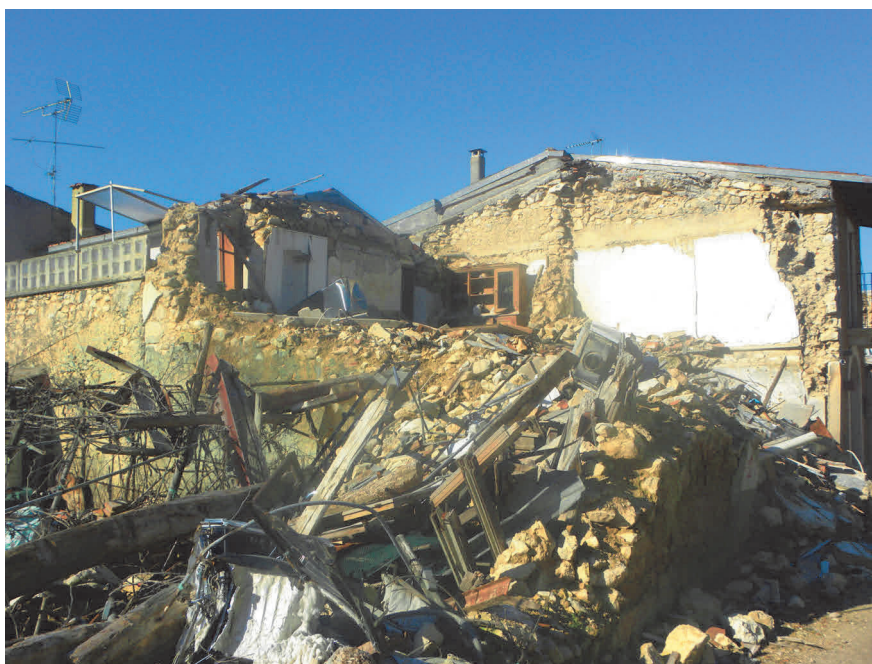
Figure 11 e 12. Ingenti danni e macerie a Onna.
