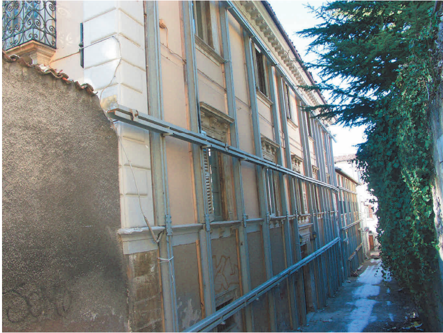
Figura 2. Un palazzo del centro storico della città di L'Aquila fortemente danneggiato e messo in sicurezza.
