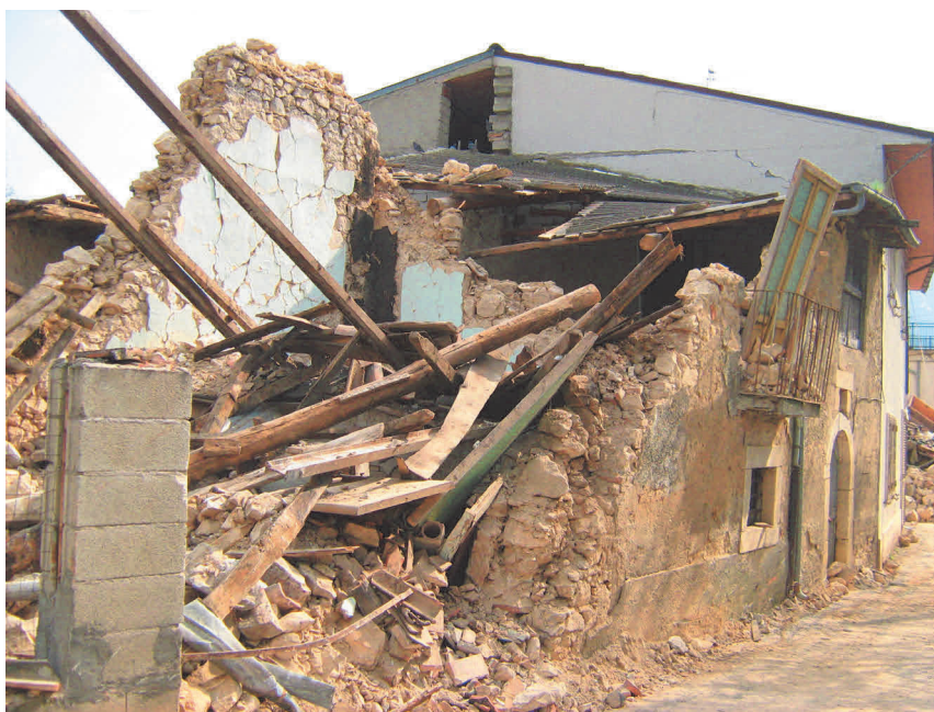
Figura 3. Un esempio di edificio gravemente danneggiato dal terremoto nella frazione di Onna (AQ).
